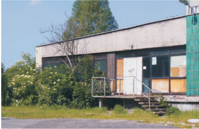
Budynek byłej stołówki w Katowicach-Ligocie przy ul. Medyków 12 przed utworzeniem Centrum Dydaktycznego.
