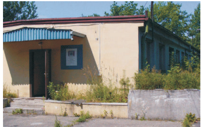
Budynek socjalny byłego Zarządu Inwestycji przy ul. Medyków 30 w Katowicach-Ligocie przed remontem.
